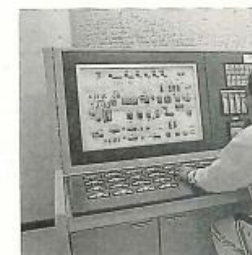
制御監視設備
